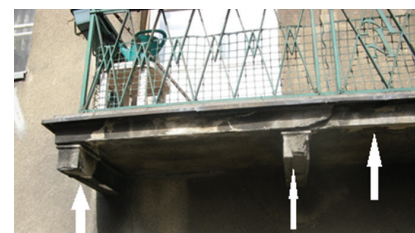
Fot. 4. Uszkodzenia tynków balkonów
