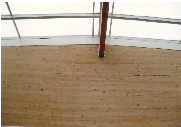
Fot. 2. Charakterystyczne silne zarysowanie na wysokości 1,2 m od spodu dźwigarów
