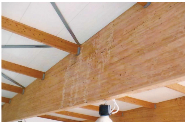
Fot. 3. Stężenie wiatrowe oraz zacieki na dźwigarach
