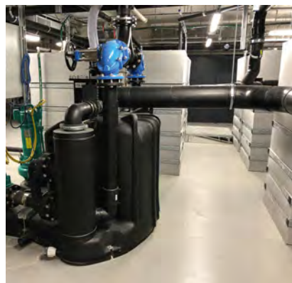
4. W tle zbiorniki stacji wody szarej
