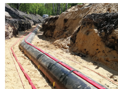
Skuteczność czujników 3DSensor z powodzeniem potwierdzono w ramach instalacji w obrębie gazociągu wysokiego ciśnienia. Monitorowanie stanu bezpieczeństwa tego typu konstrukcji jest szczególnie istotne z uwagi na ogromne konsekwencje zniszczenia
